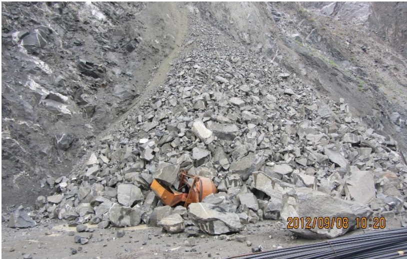
隧道对应路基边坡坍塌方
