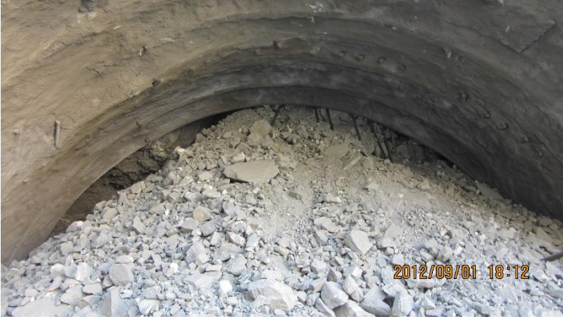
隧道拱顶坍塌
